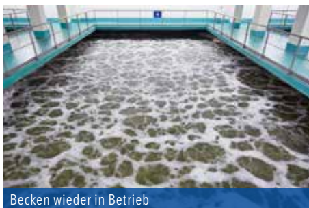
Becken wieder in Betrieb
